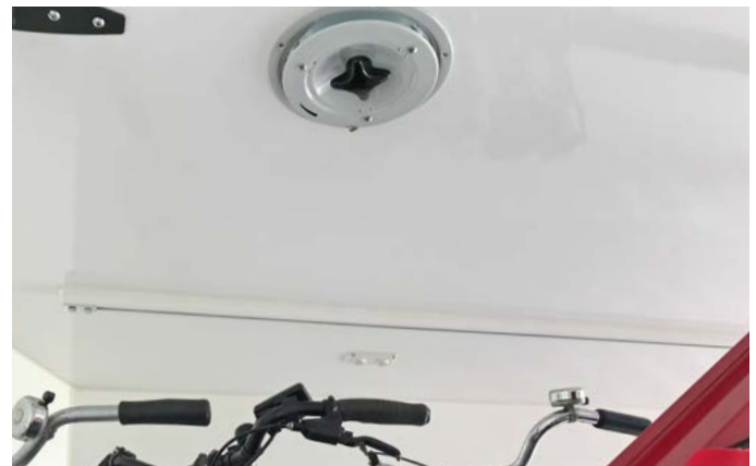
Ventilación: indispensable, por ejemplo, cuando las bicicletas están mojadas.
